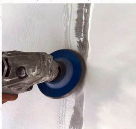
1. Mài vát cạnh dọc vết nứt (Rộng: 6 - 7cm, sâu: 5mm)
