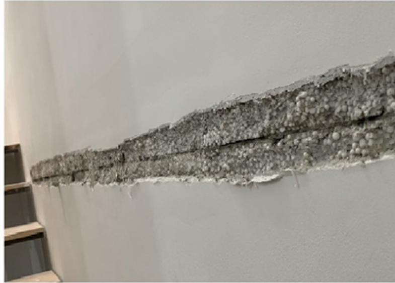
Nứt tường bê tông EPS
