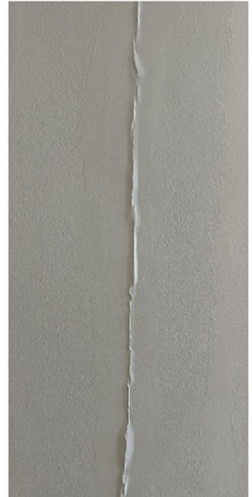
Nứt dọc khe nối tấm tường nhẹ lắp ghép: ALC, Acotec, Cemboard, EPS..v.v.. sau khi xử lý bằng keo Acrylic
